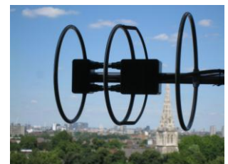
固定地点間通信のために 設置したアンテナ
